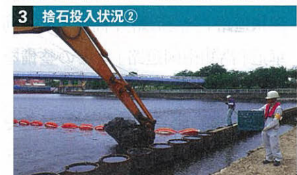
1 瀨取り状況 2 捨石投入状況① 3 捨石投入状況② 1 施工現場までは橋梁や水門の下を潜る必要があるため、千葉市中央区にある製鉄所からガット船で運ばれてきた人工石材を積載場所で土運船に移し替える 2 2 バックホウ台船で土運船の人工石材を投入。投入1回目は上部工の下端まで。2回目は上部工完了後、天端まで盛り付ける
