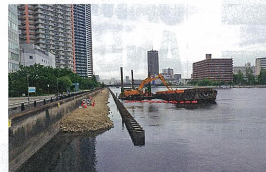
運河部分では2019年5月から6月にかけて、1回目の捨石瀨取り投入を行った。投入量は約1600m 3 。その後、写真中央に見える施工済み鋼管矢板の手前部分に新たに鋼管矢板を打設延長し、施工延長全体にわたる上部工を終え、2回目の捨石瀨取り投入を行っている
