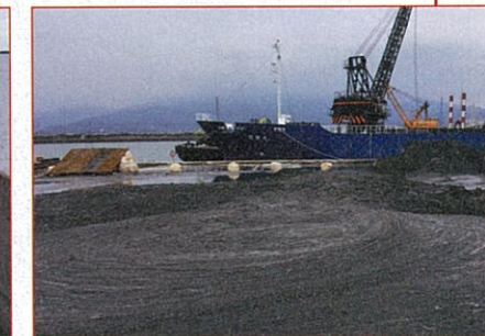
カルシア改質土は多目的起重機船で岸壁の裏埋材として現場に投入する
