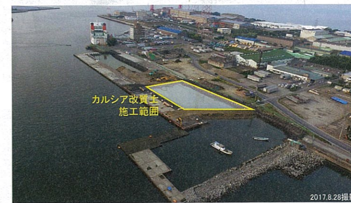
RCケーソンの手前にカルシア改質土。ノリ養殖との関係で浚渫時期が2017年6~9月に限られたことから、カルシア改質土の施工範囲は約2500m 2 の限られた区域にとどまった
